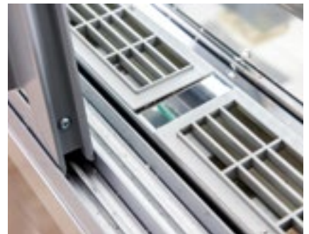
Laufschiene der Schiebetür und Luftführungsgitter
