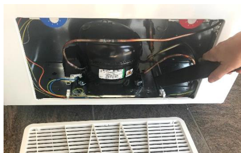
Abbildung 3 – Reinigung des Kompressorraums
